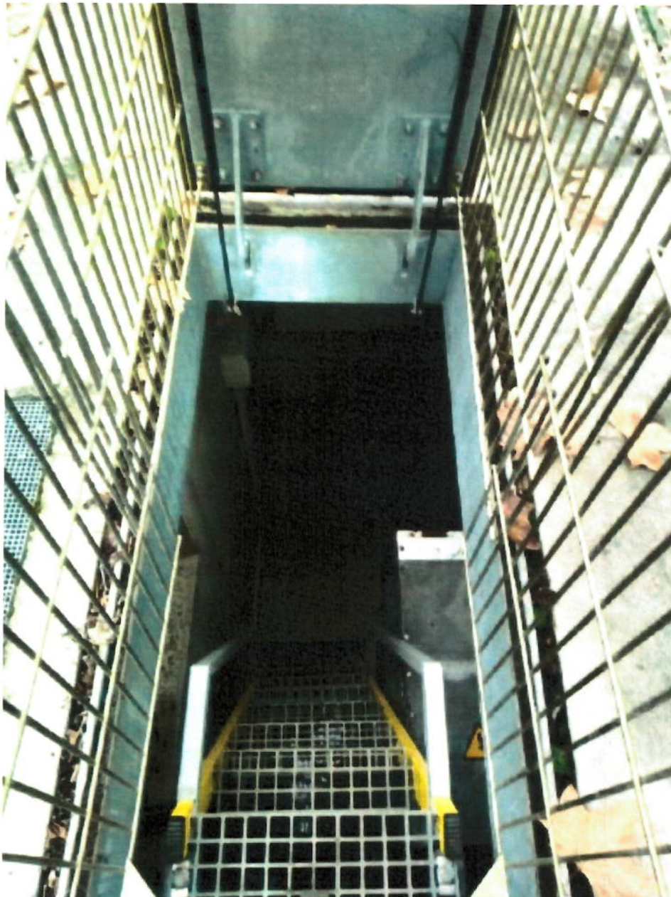
Foto 2: Escalera de bajada al interior del centro de seccionamiento y vista de la parte superior de la celda de salida de línea justo en la vertical de la tapa de la trampa.
