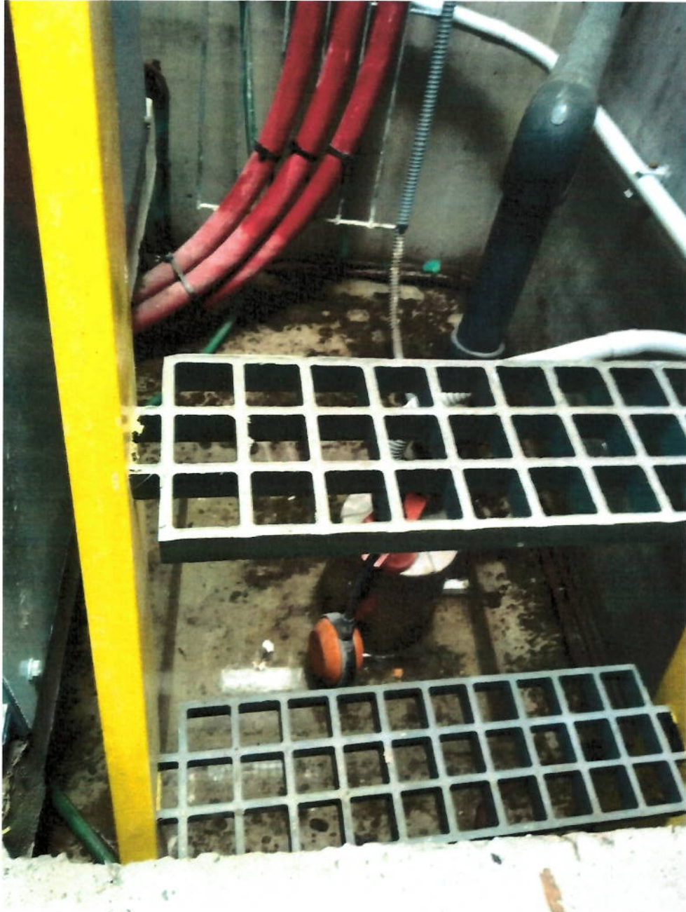
Foto 3: Vista de la escalera y de la boya de la bomba de achique
