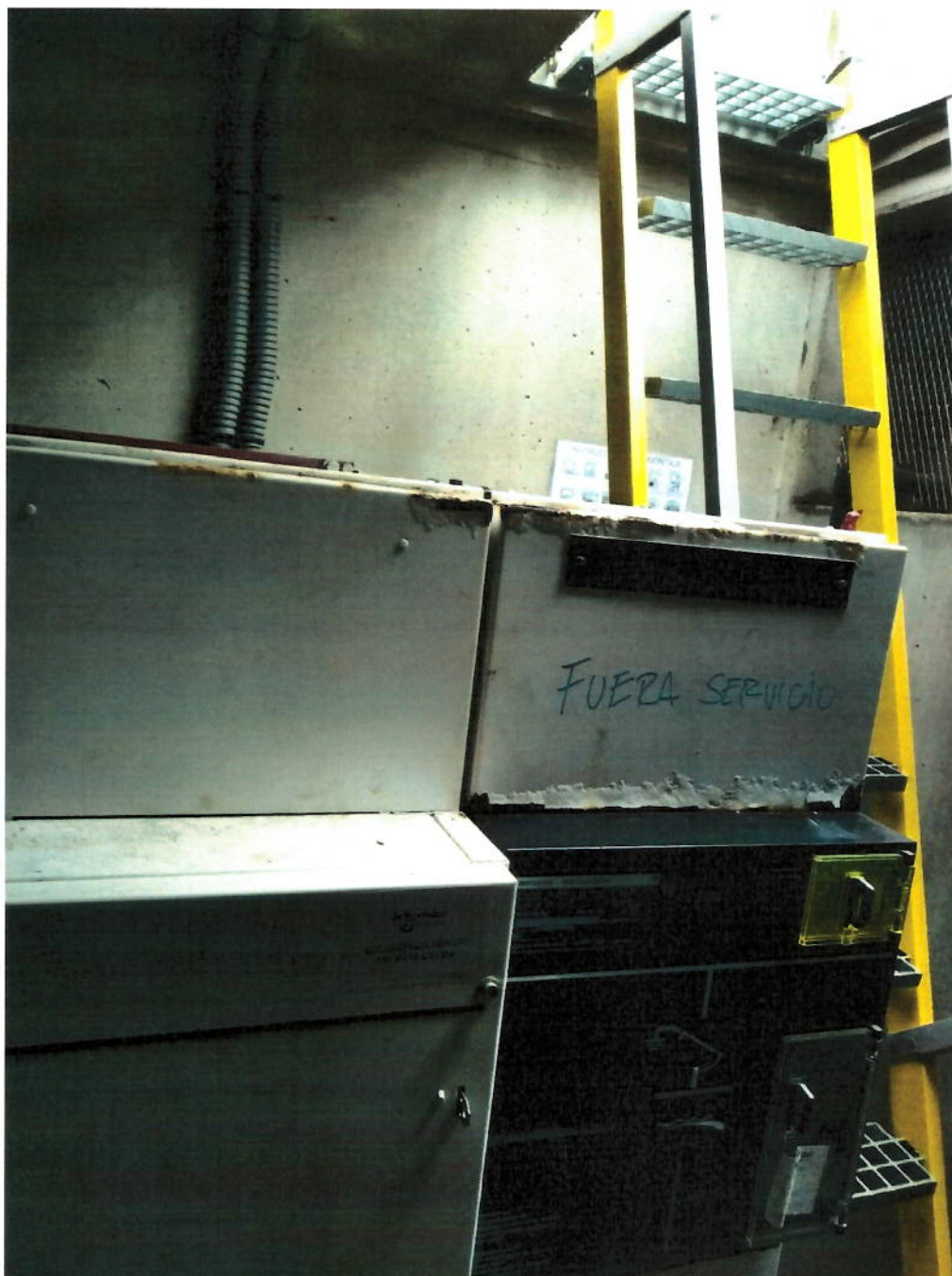
Foto 4: Vista exterior de la celda de salida de línea con óxido.
