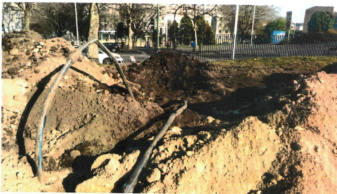
Ilustración 5. Tubos de red de riego en zona de hiedras.
