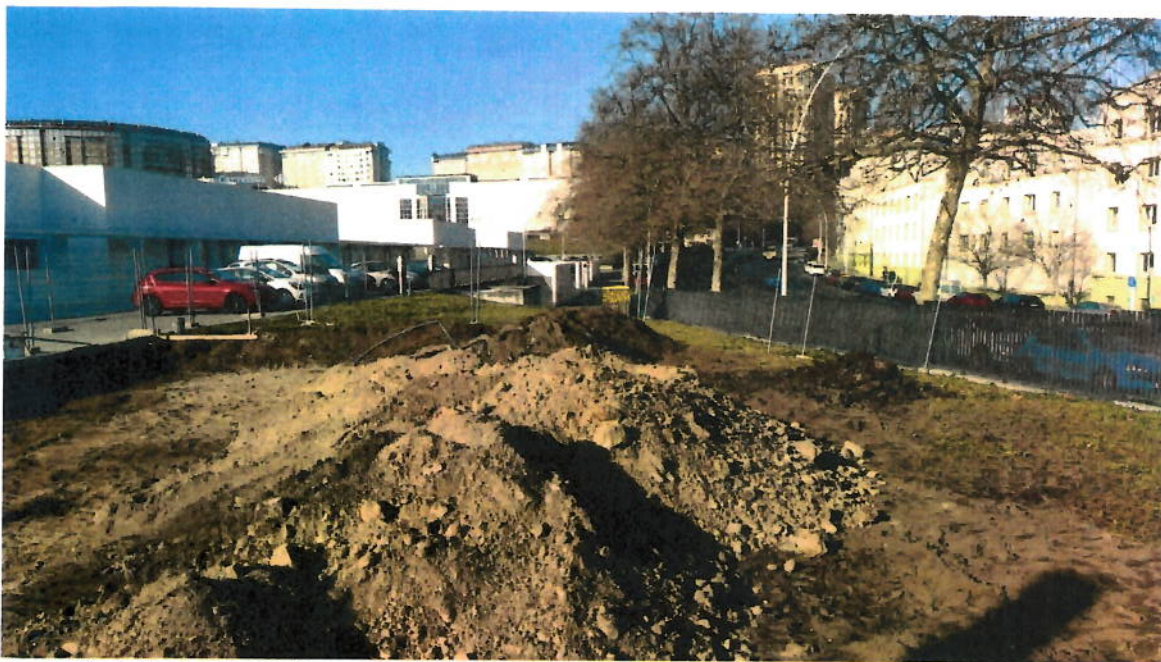
Ilustración 3. Terreno removido por la cimentación de la cubierta.
